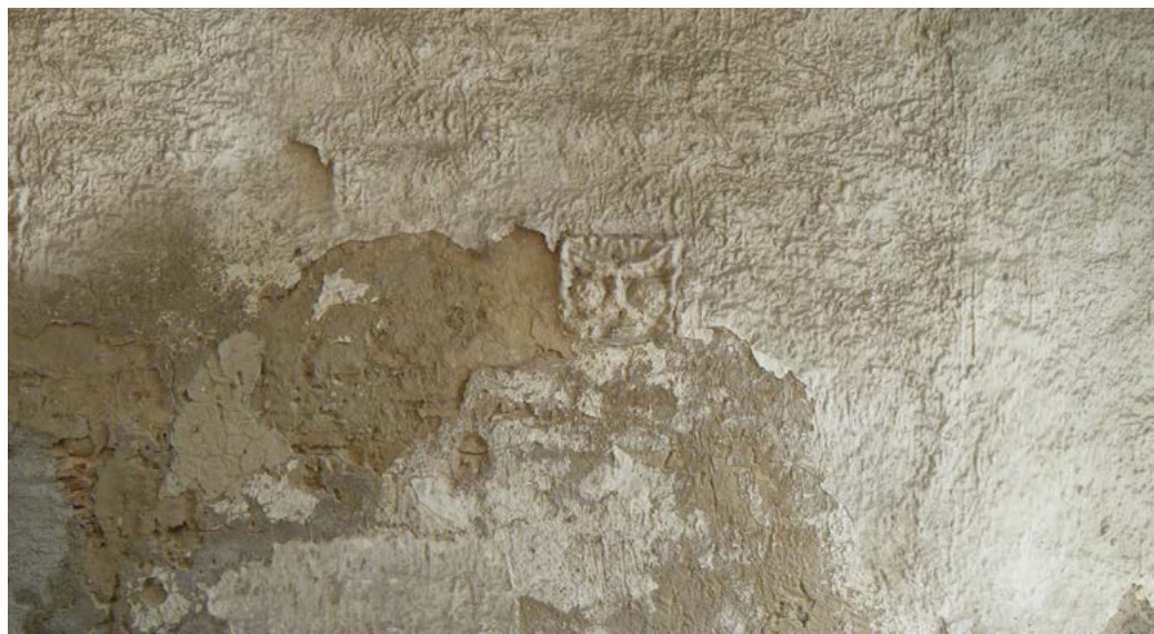
Patologías provocadas por ascensión de humedad por remonte capilar
